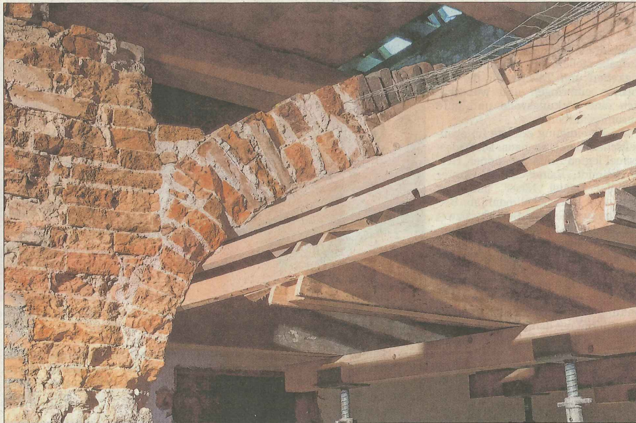
Das Tonnengewölbe der benachbarten ehemaligen Garage soll erhalten bleiben und wird daher mit einer speziellen Konstruktion während der Bauzeit gestützt. Foto: Rebecca Weber
